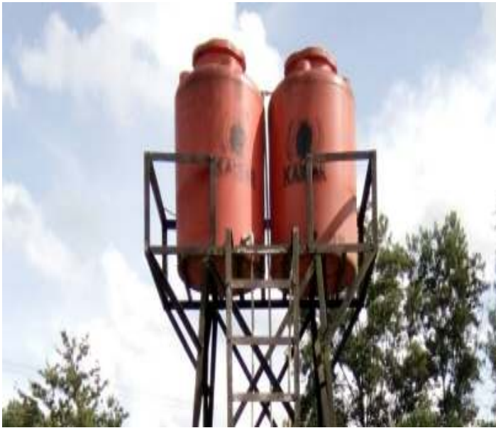
1.Sarana Penyediaan Air Bersih
