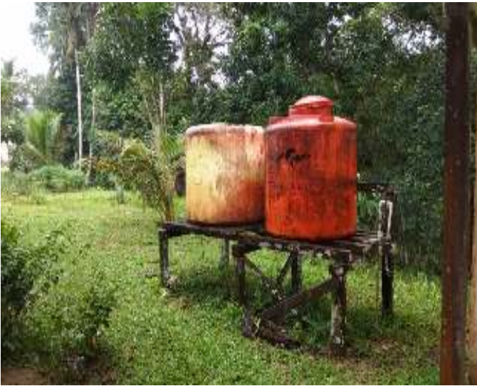
1. Sarana Penyediaan Air Bersih
