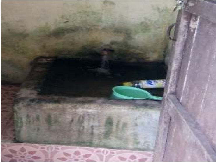
1. Sarana Penyediaan Air Bersih
