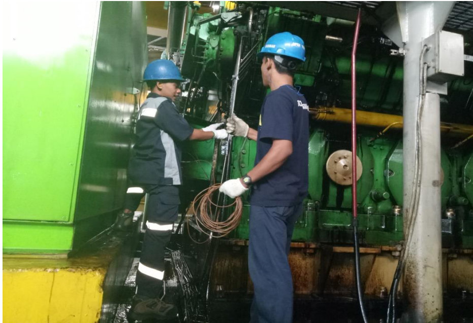
Lampiran 3 : Pemasangan Sensor TDC
