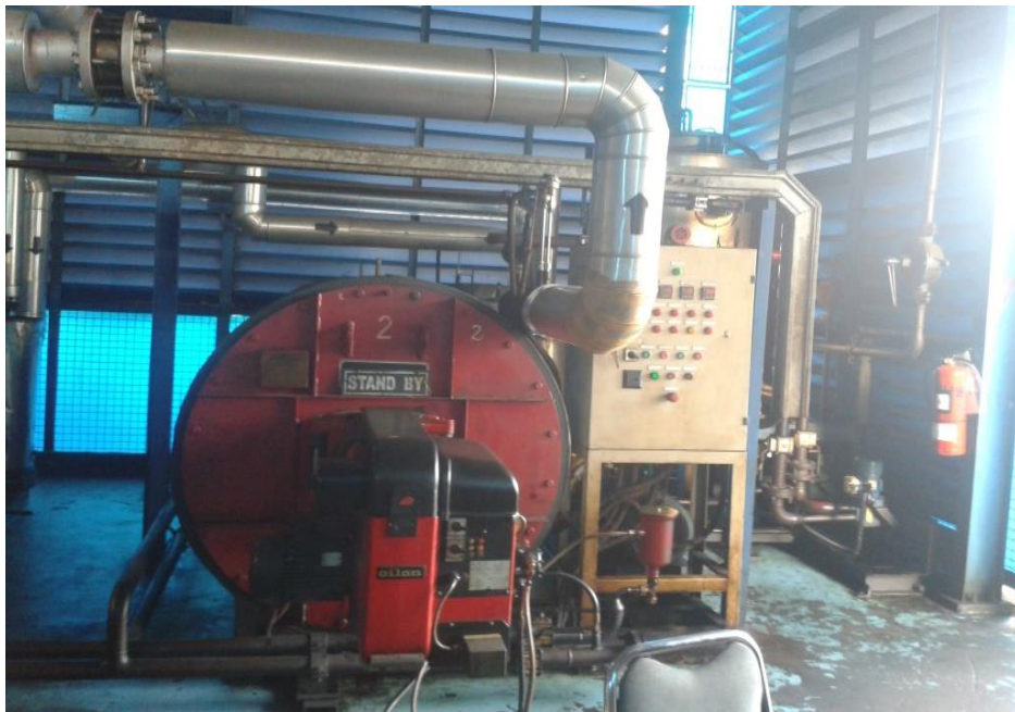
Lampiran 6 : Boiler Pemanas MFO
