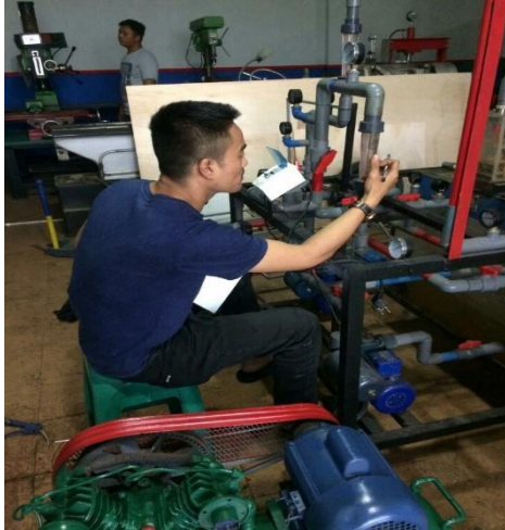
Mencatat Debit Aliran Yang Tertera Pada alat Ukur Flowmeter.
