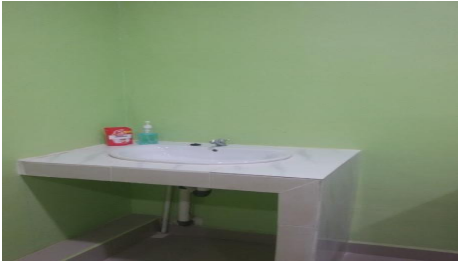
Gambar 21. Fasilitas hand hygiene di ruang IGD
