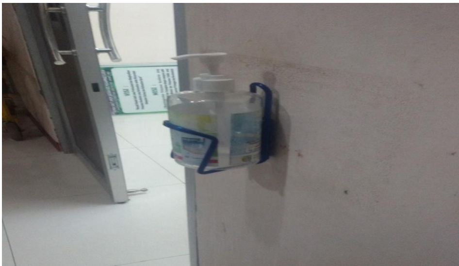
Gambar 22. Fasilitas hand hygiene di ruang IGD
