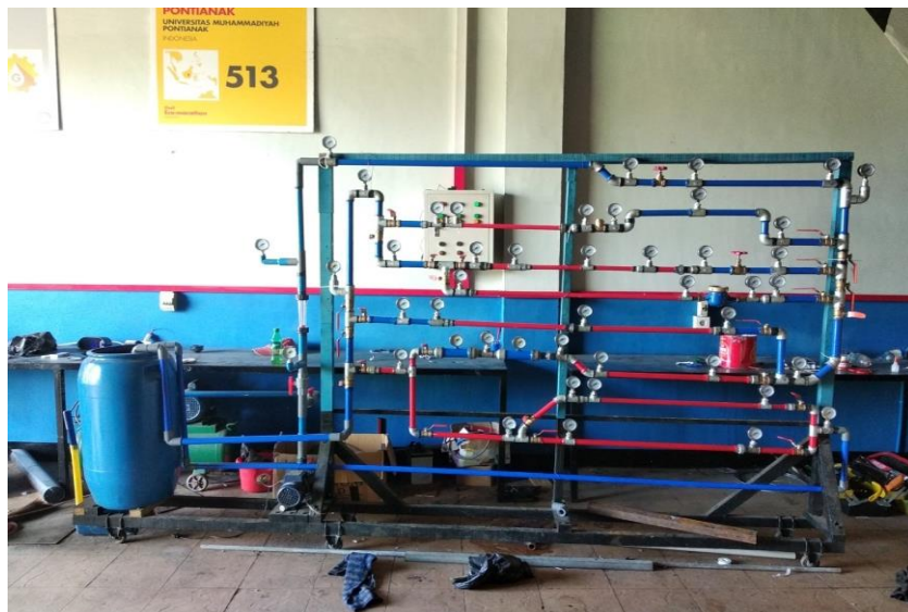
Lampiran 2 Alat Uji Sistem Aliran Fluida Menggunakan Pipa Galvanis
