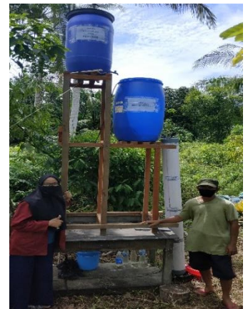
Bangunan filter (penelitian) di Rumah Warga
