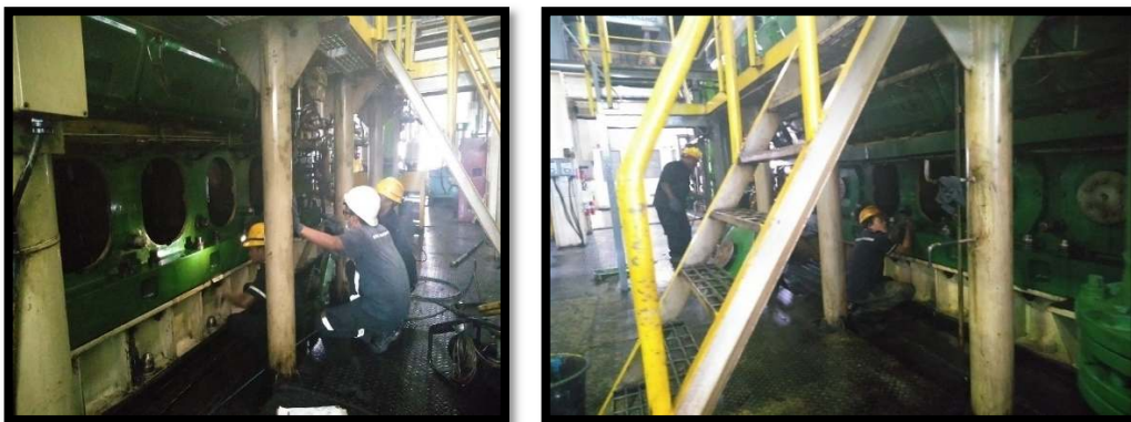
Gambar V.4 Proses Perawatan Mesin
