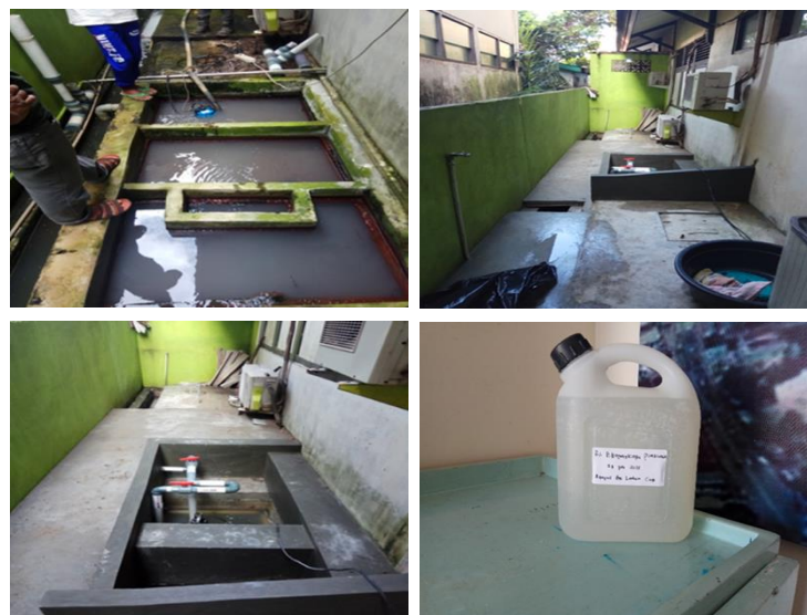
Gambar V.9 Instalasi IPAL Sumber : (Data Primer, 2020)
