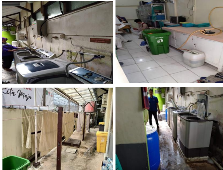
Gambar V.7 Instalasi Laundry Sumber : (Data Primer, 2020)
